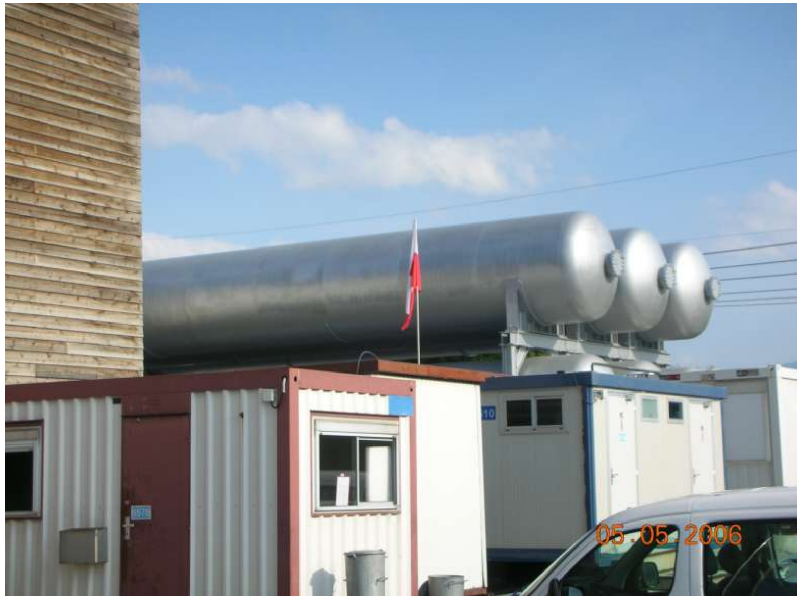
Serbatoi contenenti elio liquido necessario al raffreddamento dei magneti
